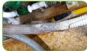
파손된 플렉시블 호스 2
