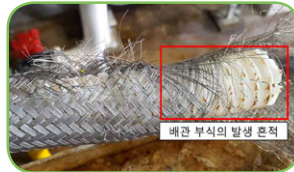
파손된 플렉시블 호스 1
