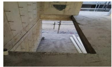
[Floor opening 바닥 개구부]
