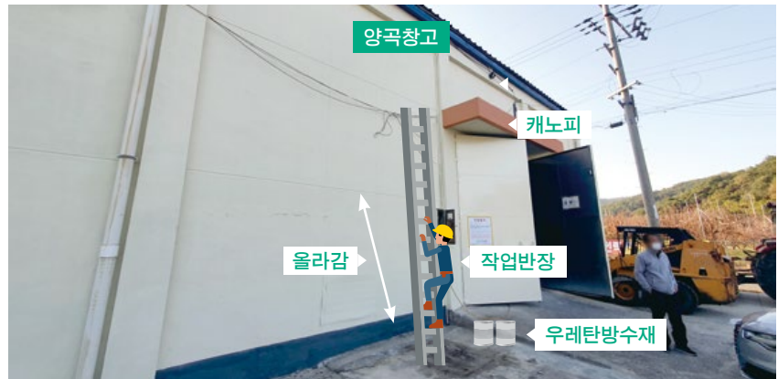
재해 당시 사다리 설치 방향 추정. 사다리를 펼쳐도 닿지 않을 만큼 높은 고소작업 위치로 인해 불가피하게 벽면에 사다리가 설치되었다
