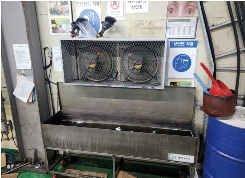
F기업 세척 작업장에는 환풍기만 설치되어 있었다. 유해 물질을 배출하기에는 역부족이었다
