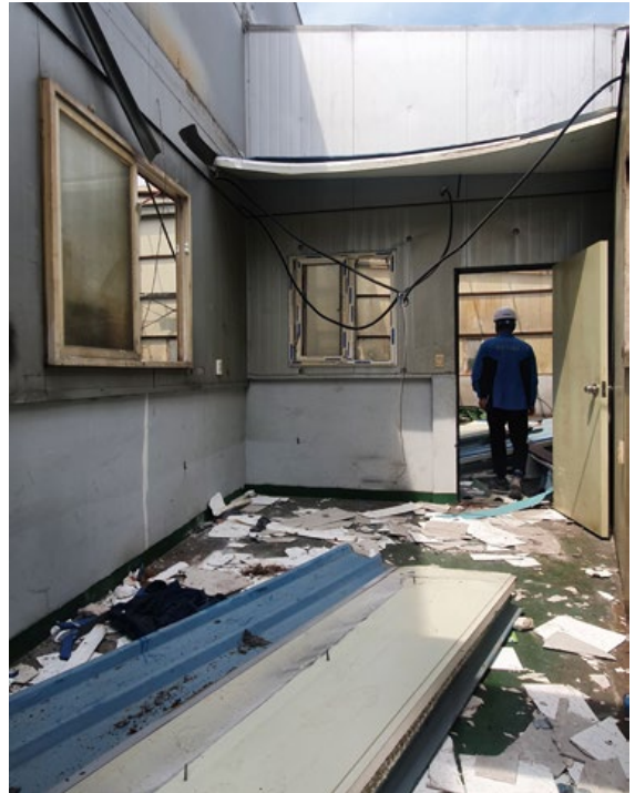
샌드위치패널이 지붕에서 탈락한 철거 공사 현장
