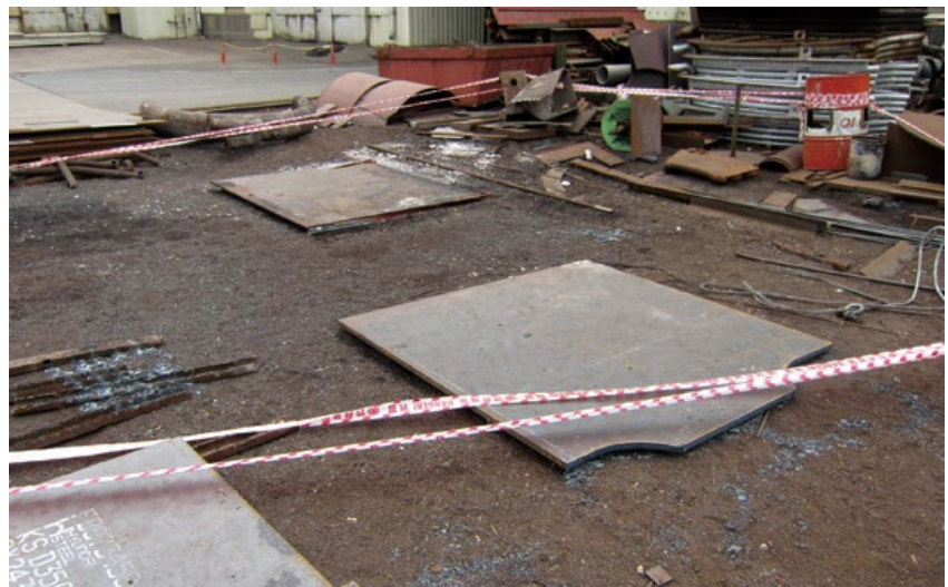
당시 방열판이 넘어진 작업 현장
