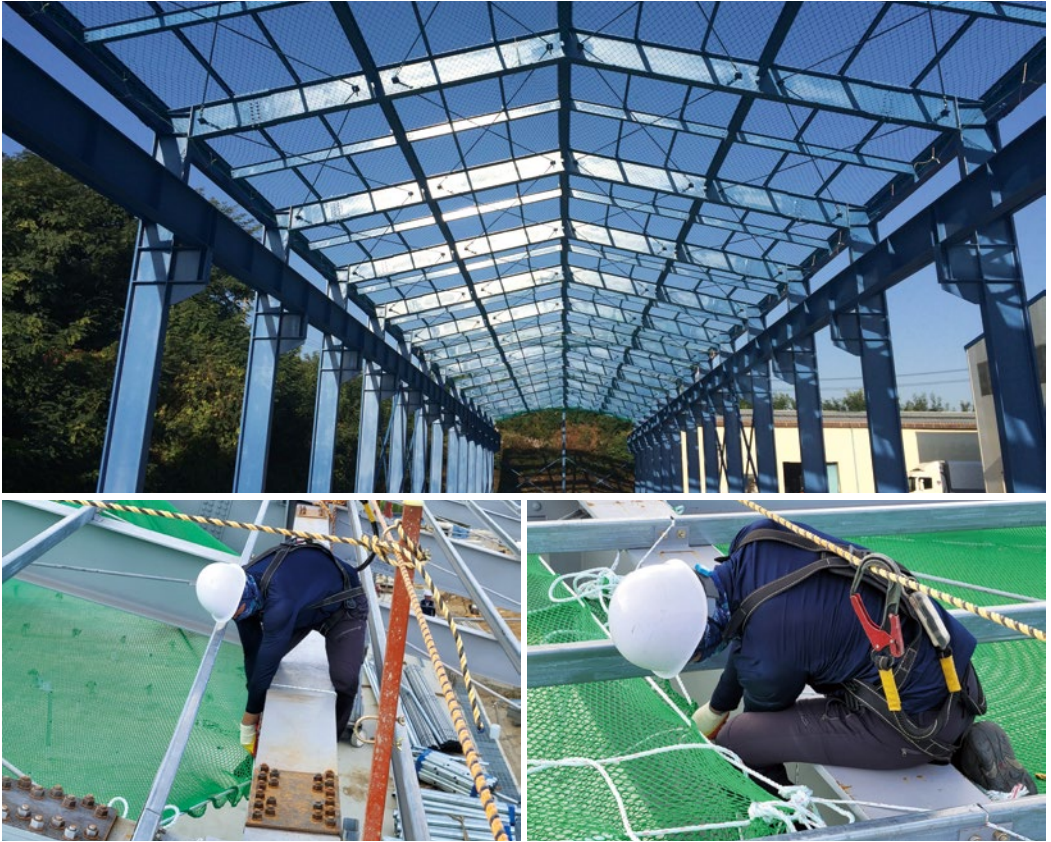
위. 지붕 철골 하부에 설치된 추락방호망 아래. 안전대를 안전대 부착설비에 체결하고 작업하는 모습
