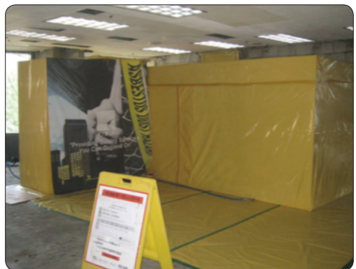
[그림 10-7] 위생설비 측면에 설치한 석면폐기물 반출구 예시
