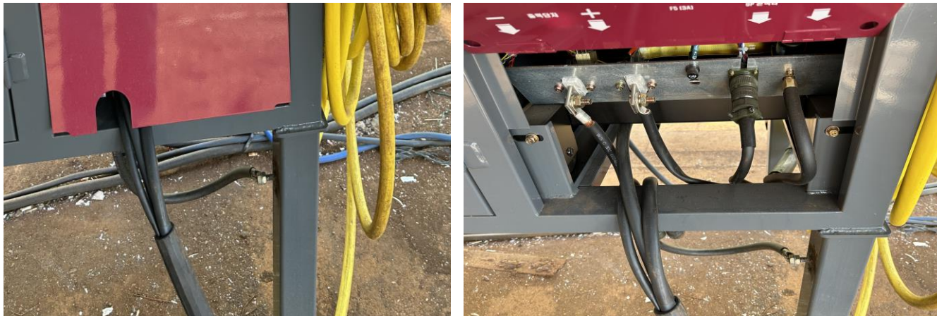
용접기 케이블과 충전부 접속 상태
